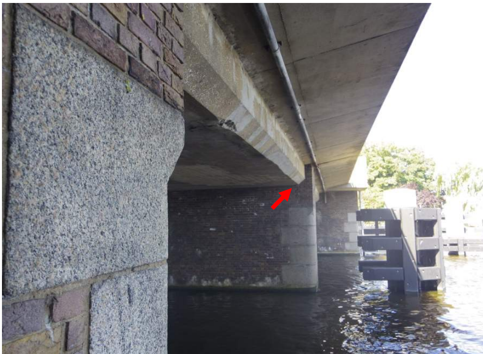
Figuur 40: Op de overgang tussen metselwerk en beton zitten dilatatievoegen. Hier is ruimte voor overwinterende vleermuizen.
