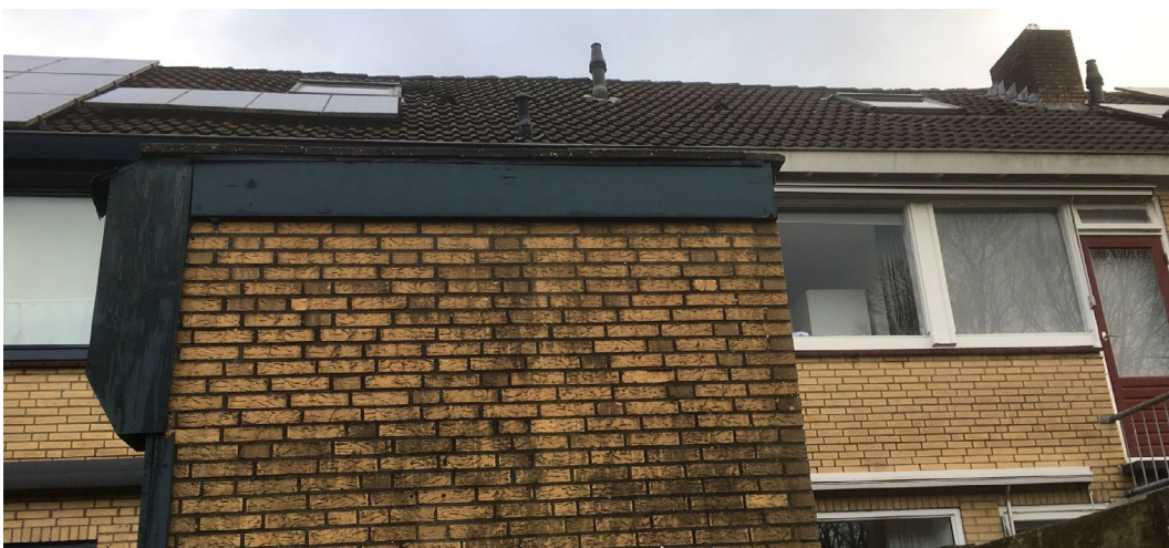
Figuur 1: Foto van de gevel met het vleermuisboeiboord (blauwe plank).
