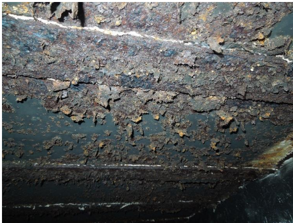
Figuur 30. Roestvorming en deels doorgeroeste stalen plafondafwerking
