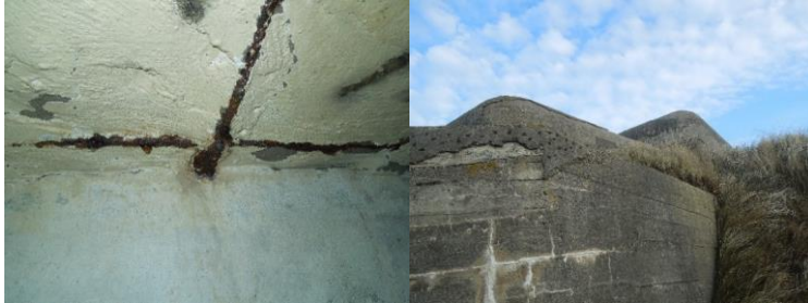
Figuur 28 (links). Betonrot door carbonatie. Staal gaat bij een lage pH roesten. Daar waar het wapeningstaal vlak onder het betonoppervlakte ligt springt het beton los.
