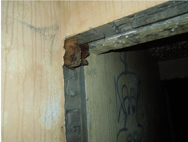
Figuur 31. Weggerotte kozijnen in een van de overige objecten
