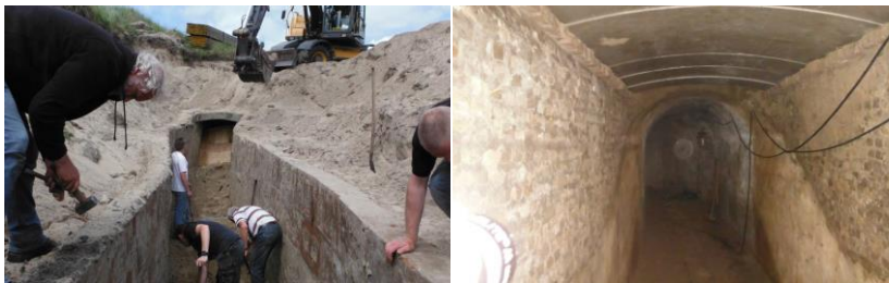
Figuur 62. Bunker Noordwijk, links gang zonder dak en rechts met nieuwe consoles.
