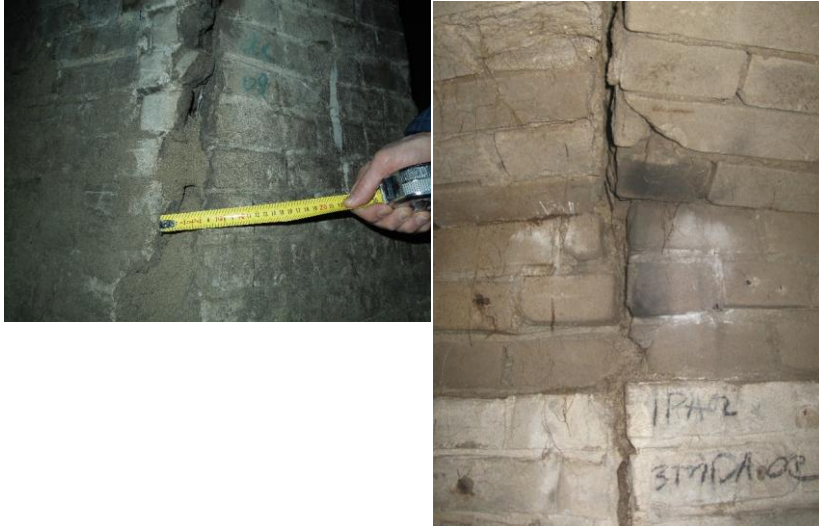
Figuur 22. Scheuren met name op hoekpunten waar twee gangen op elkaar aansluiten.
