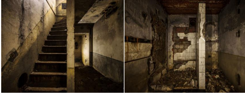
Figuur 26. Impressie van binnenzijde S414. De trap tussen begane grond en eerste verdieping. De restanten van de wc's. Foto's: Bas de Mos
