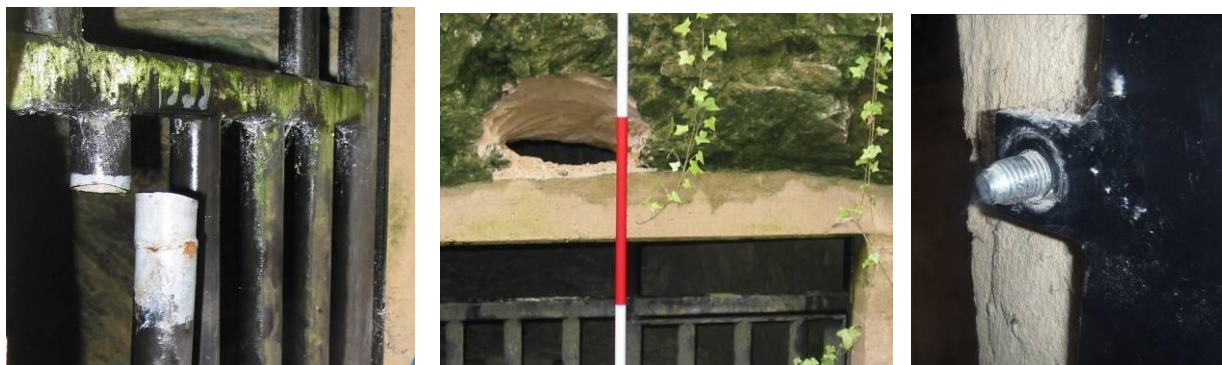
Figuur 61: Voorbeelden van inbraakpogingen (het hekwerk, de mergelgroeve en de scharnieren)
