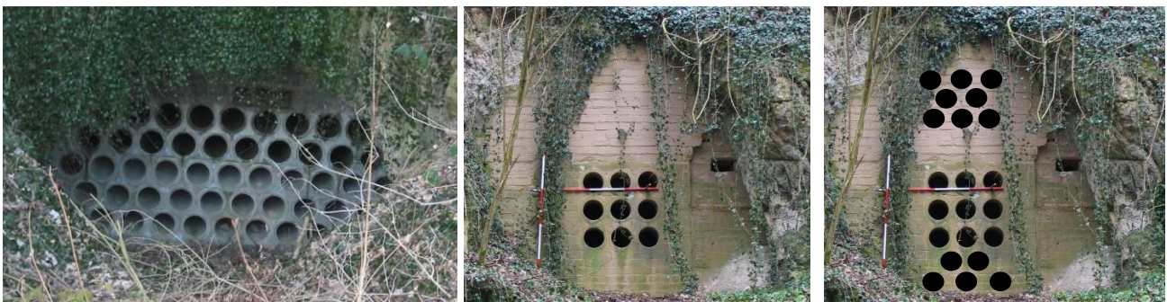
Figuur 64: (Links) Ingang van de Geulhemmergroeve. Een voorbeeld van optimale toepassing van rioolbuizen bij de afsluiting van een mergelgroeve. (Midden) De ingang van de Slangeberg, huidige situatie met hinder van de luchtstroming. (Rechts) Een verbeterde situatie met meer mogelijkheden voor luchtstroming.
